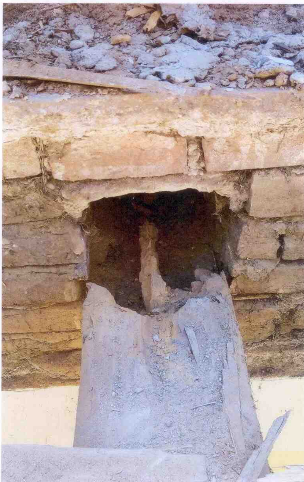
Detail destrukce zhlaví jednoho z trámů
